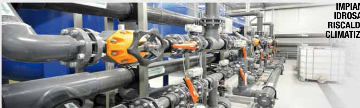
IMPIANTISTICA SOLARE ALTE TEMPERATURE
